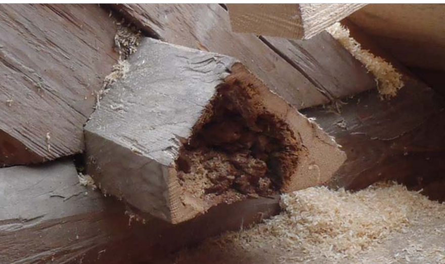
Die Schäden die ein holzerstörender Pilz an einer Holzkonstruktion verursacht, wie hier in einem Dachstuhl, sind oft von außen nicht erkennbar.
