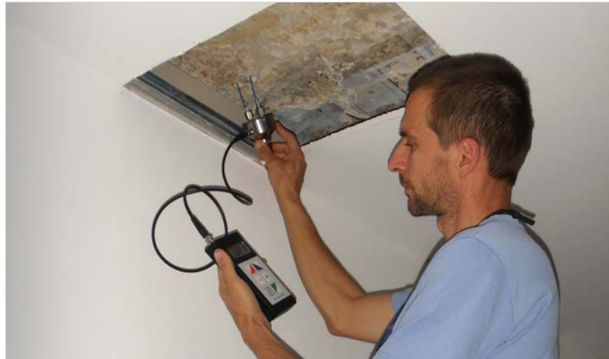
Holzfeuchtemessung an einer Dippelbaumdecke nach einem Wasserschaden.
