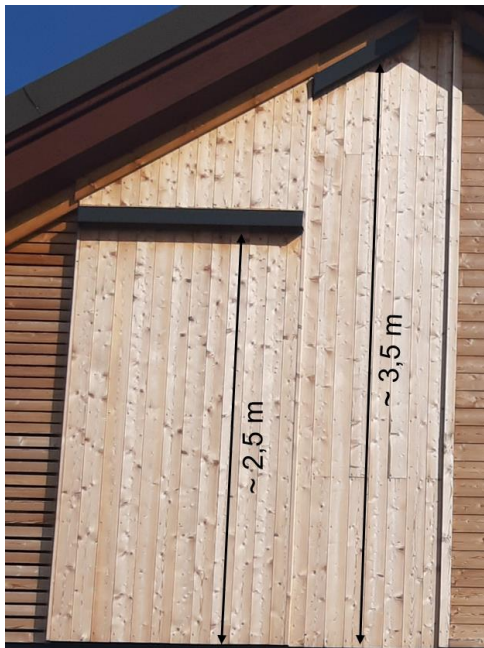
Abbildung 10: Unterschiedliche Hinterlüftungsspaltlängen auf der Westfassade.
