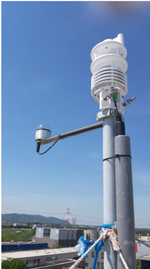
Abbildung 15: Wetterstation Ahlborn FMD 770 am freistehenden Flachdach des ACA.
