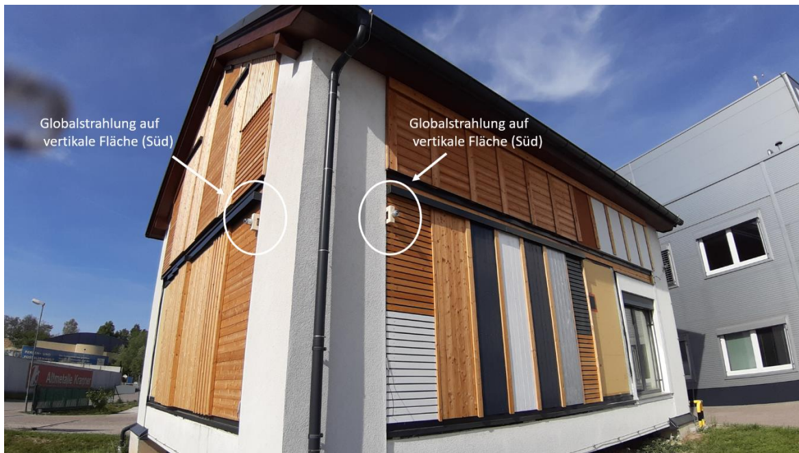
Abbildung 16: Vertikal ausgerichtete Globalstrahlungssensoren auf der Süd- (Ahlborn FLA633-GS) und Westfassade (Ahlborn FLA613-GS) des Forschungshauses.
