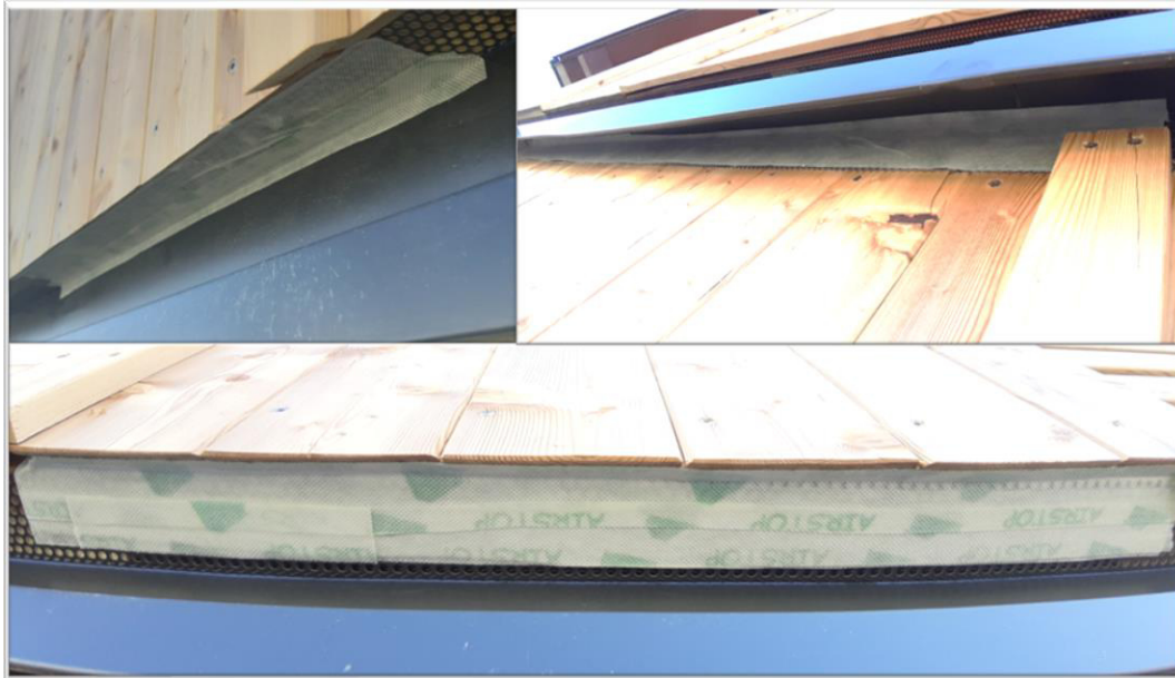
Abbildung 13: Beispielhafte, abgeklebte Öffnungen. Oben links: Verschlossene Zuluftöffnung. Oben rechts: Verschlossene Abluftöffnung. Unten: 90 % verschlossene Zuluftöffnung.
